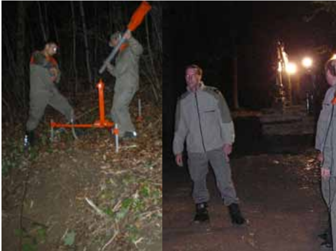
Aufstellen der Beleuchtung und erste Inspizierung...
